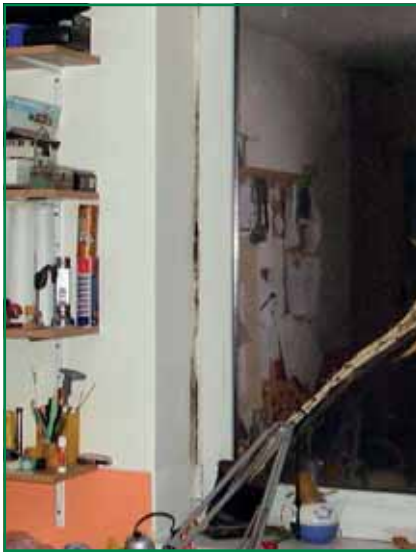
Obr. 16: Rast plesní na vnútornom ostení okna ako dôsledok nedostačitého zateplenia ostenia v exteriéri a chybného užívania bytu
